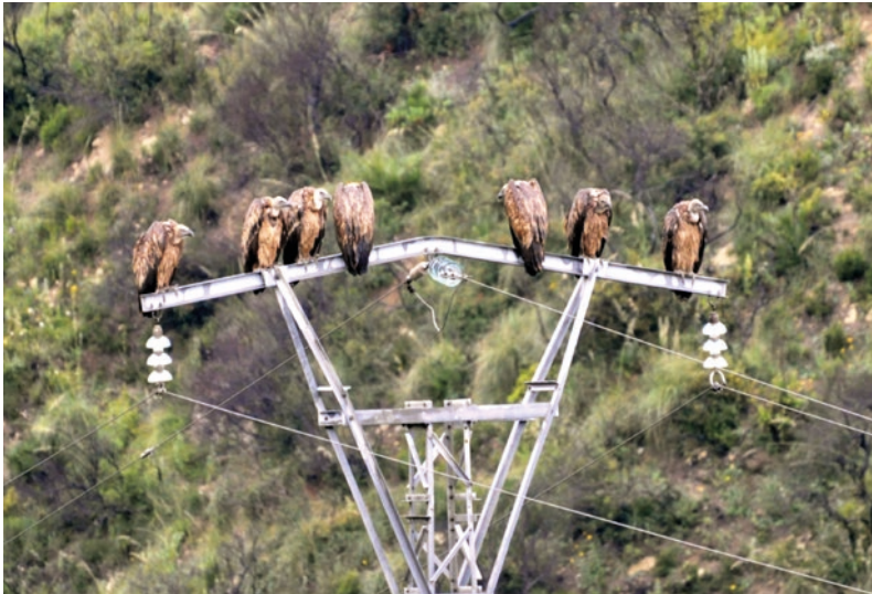
Lorsqu'ils utilisent les pylônes électriques comme perchoirs pour le repos ou la chasse, les rapaces risquent d'être électrocutés et de mourir. © R. El Khamlichi/AMPOVIS
